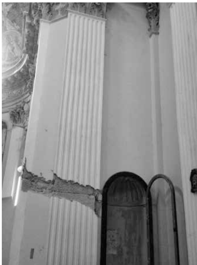
Figura 4 Lesioni nei piedritti di sostegno degli archi trionfali
